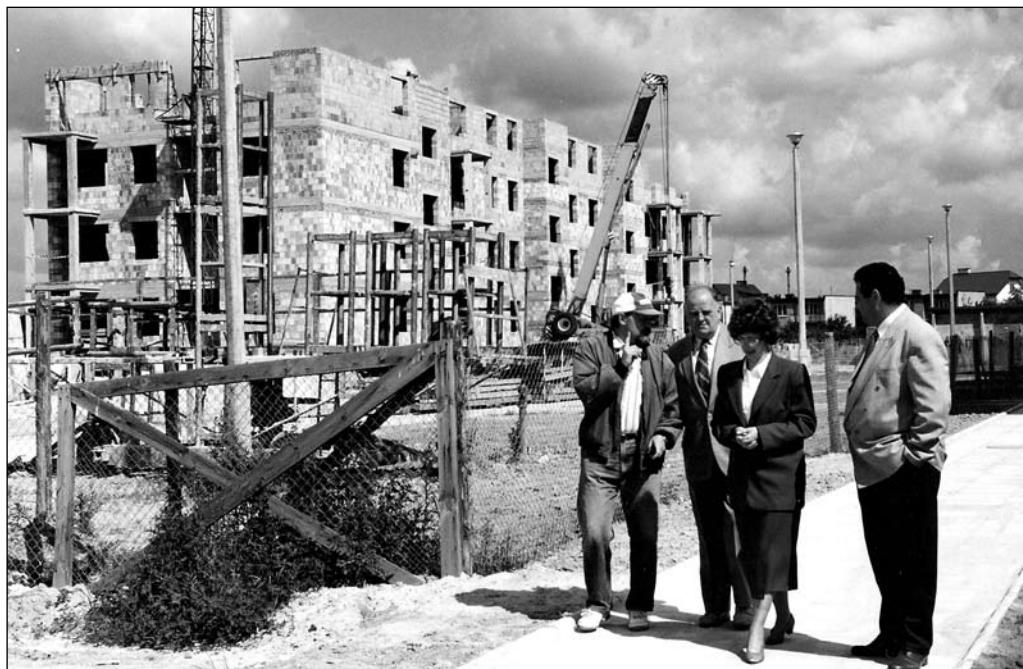
Budynek na os. A. Czapskiego w trakcie realizacji w 1997 r. przy ulicy Nowej 5. Na zdjęciu od lewej: Grzegorz Wołowicz — kierownik budowy, Wiesław Wiliński — prezes SMLW, inż. Ewa Wichrowska — główny specjalista ds. inwestycji i Paweł Żółtowski — współwłaściciel Hydropolu, firmy wykonawczej. Fot. archiwum GSM
