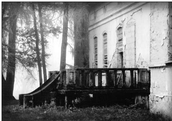
Zdewastowany pałac i park. Stan z 8 XI 2008 r. Fot. Marek Konarski
